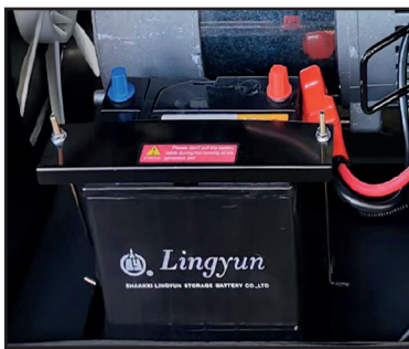
Batterie pour démarrage électrique
