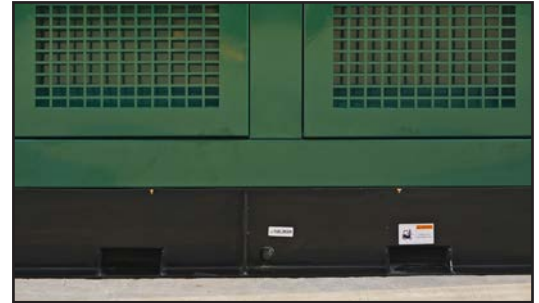
Vidange réservoir et passage de fourche
