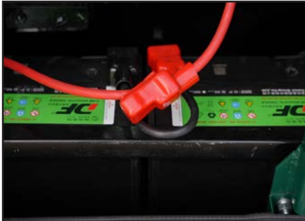
Batterie pour démarrage électrique
