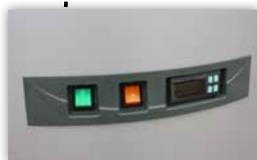
Panneau de commande du groupe froid et interrupteur pour l'éclairage (220V)
